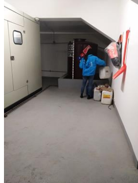
Imagen 6. Planta Eléctrica. Fuente: MinTic
