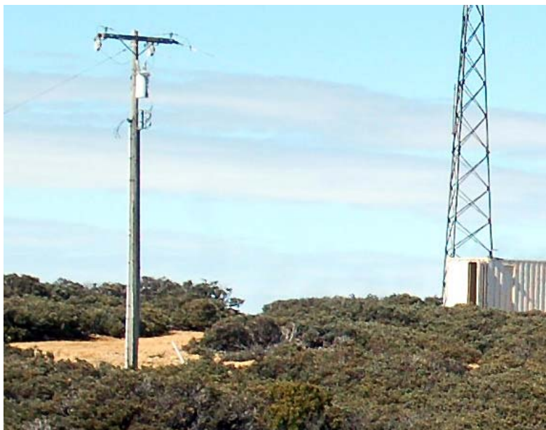
Figura 19: –Antena en poste de energía
