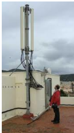
Figura 18: –Mastil sobre azotea
